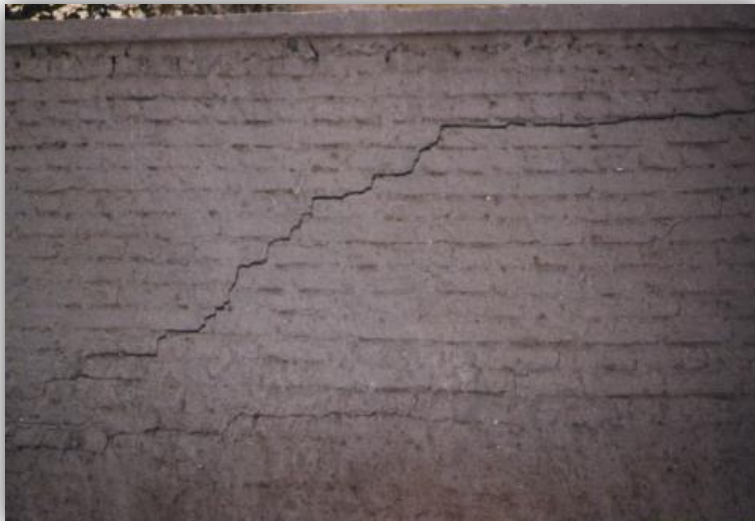
شروخ نتيجة الهبوط
