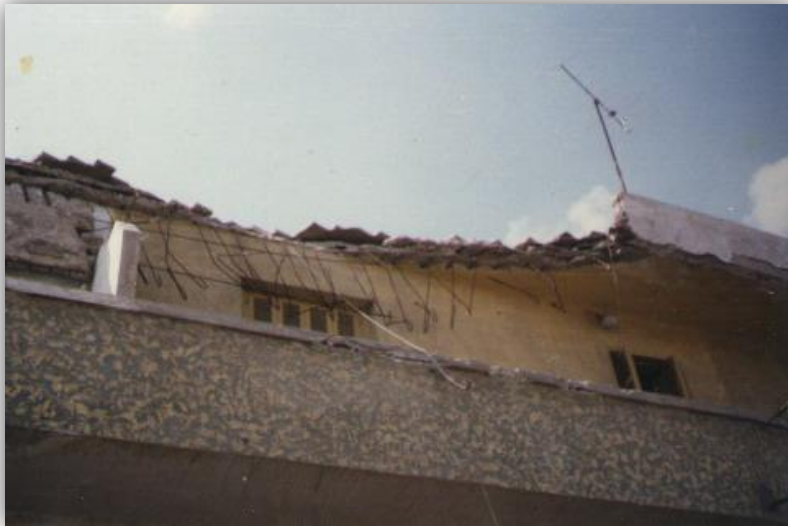
انهيار فى السقف نتيجة الخطأ فى وضع حديد التسليح
