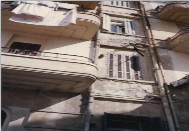
شرخ نتيجة تسرب مياه الصرف
