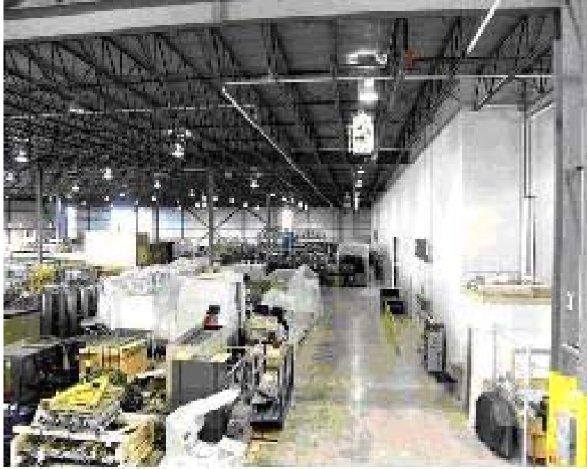
ويوضح الشكل (١ - ١١) منظر عام لورشة في مصنع تم تركيب الموصلات على أرفف معدنية معلقة .
