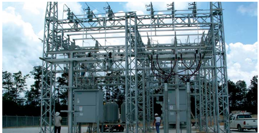
محول كهربائي ضخم في محطة الشبكة الكهربائية
