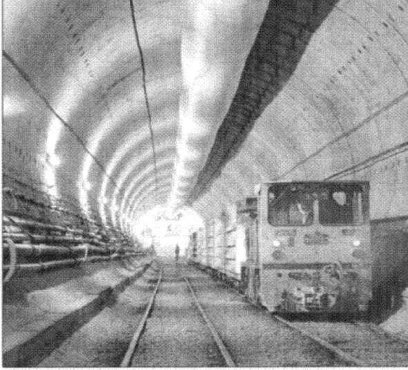
شكل 1-24 أسلاك الألياف البصرية معلقة على جدران نفق قطار (تقدمة QA photos Ltd)
