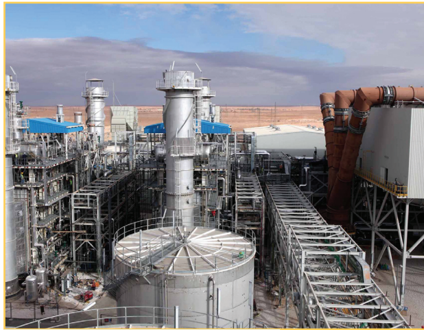
إنشاء محطات للكهرباء في اليمن
