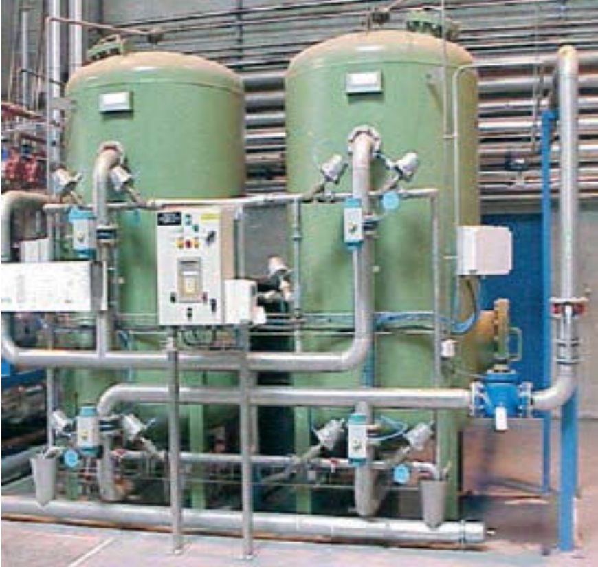
الشكل 5 - 42: محطة إزالة القساوة بالمبادل الشاردي.
