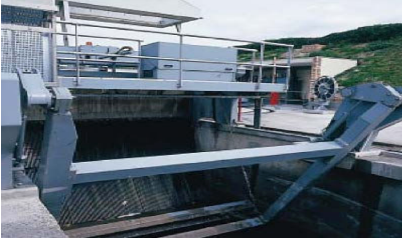
شكل 5 - 1: صورة لنظام فصل المعلقات بالشباك (Dégrilleur) لمحطة معالجة المياه.
