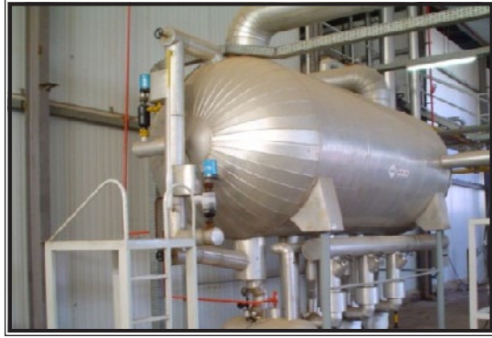
شكل (10.12): خزانات سائل النشادر المضغوط بصمامات الأمان لتنفيس الضغط الزائد.
