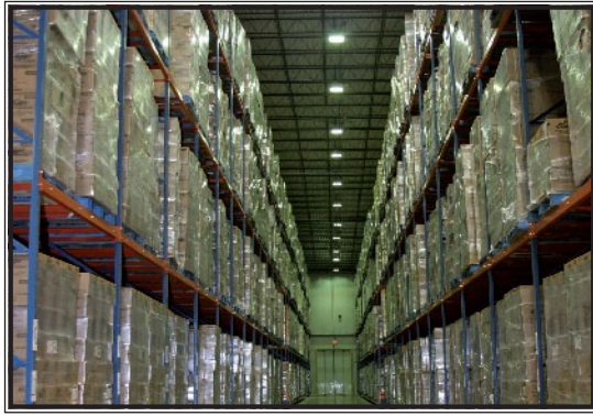
شكل (12.12): غرف تبريد بنظام إطفاء الحرائق برشاشات سقوية.
