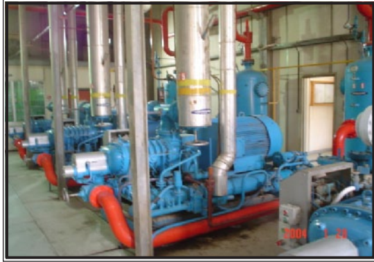
شكل (1.12): محطة تبريد تجاوز عمرها 30 عام ويندر توفير قطع الغيار لها.
