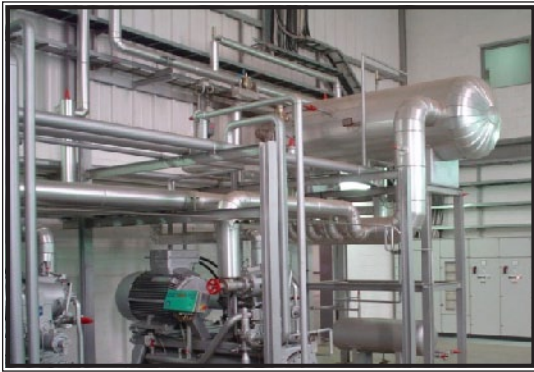
شكل (7.9): غرف المحركات بأحد مشاريع التبريد.
