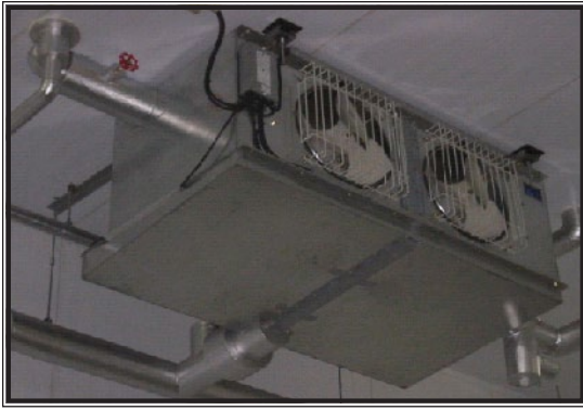
شكل (4.10): مبخرات نظام التبريد باستخدام النشادر/ ثاني أكسيد الكربون.
