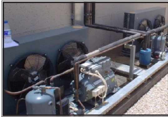
شكل (12.4): وحدات تكثيف تعمل بضاغط ترددية.
