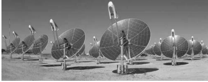
شكل (11) محطة نظام طبق سترلينج في إسبانيا
