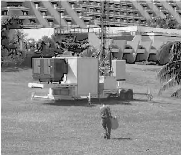
الشكل (5-1): مولد يعمل بالديزل لتزويد محطة تقوية هاتف خلوي kW 2 مع ضوء غارات عام في ساحة فندق بمدينة كانكون في المكسيك. ويجب حضور عامل التشغيل كل 12 ساعة لأعمال إعادة التعبئة - فلماذا لا يُستخدم مولد فولتضوي بدلاً من ذلك؟
