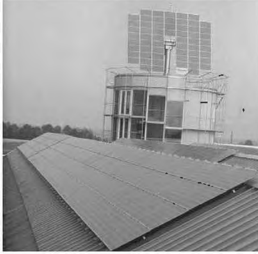
الشكل (10-1): منظومات فولتضوئية ثابتة، ومولد فولتضوئي 6.6 \text{ kW}_p بجهاز تعقب ثنائي المحور ((Hans Grohe)، (Offenburg)).
