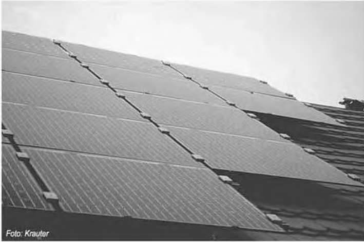
الشكل (2-16): مولد فولتضوئي سقفي بمنظومات لإطارية ومركبات تثبيت.
