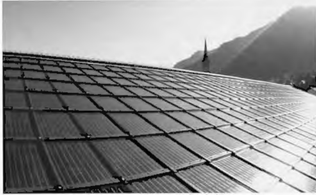
الشكل (9-10): سقف مغطى ببلاط سقف شمسي مصنوع بواسطة شركة نيوتيك (Newtec) السورية (ويلدانو (Wildanu)).
