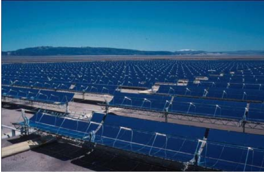
شكل (7) : مرايا القطع المكافئ لمحطة توليد الكهرباء من الطاقة الشمسية الحرارية في منطقة كرامر بكاليفورنيا
